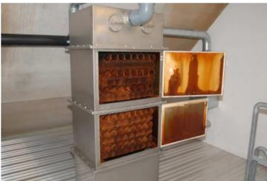
Eks. på et lukket beluftsanlæg
